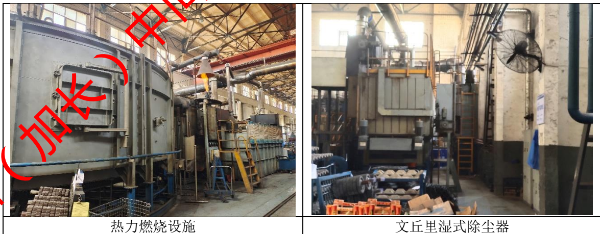
图 3-2 废气治理设施现场照片
