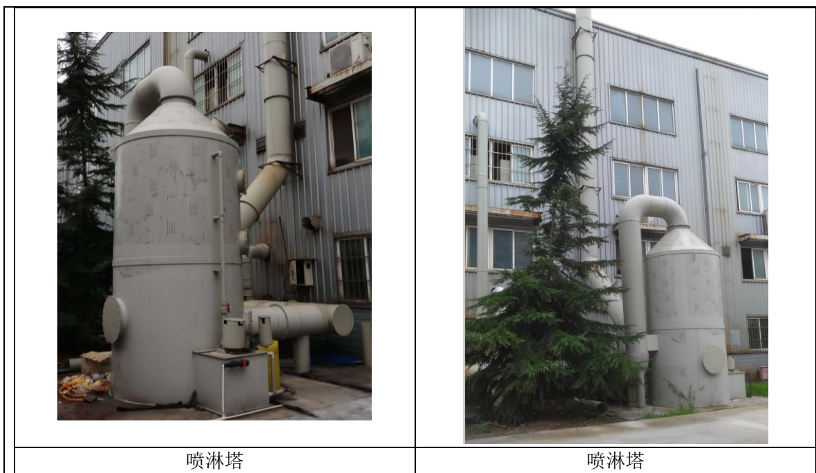
图 3-1 水处理设施现场照片
